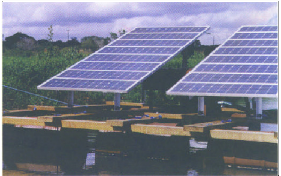
Foto 3: Sistema de Bombeamento para Irrigação na Bahia Projeto CEPEL/NREL/COELBA
