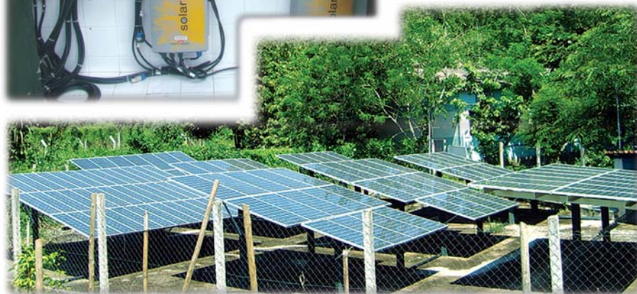
Vista geral do quadro de inversores (após reparo), do atual Centro de Monitoração com os inversores Enersolis e dos módulos fotovoltaicos que integram o sistema de 12,2kWp.
