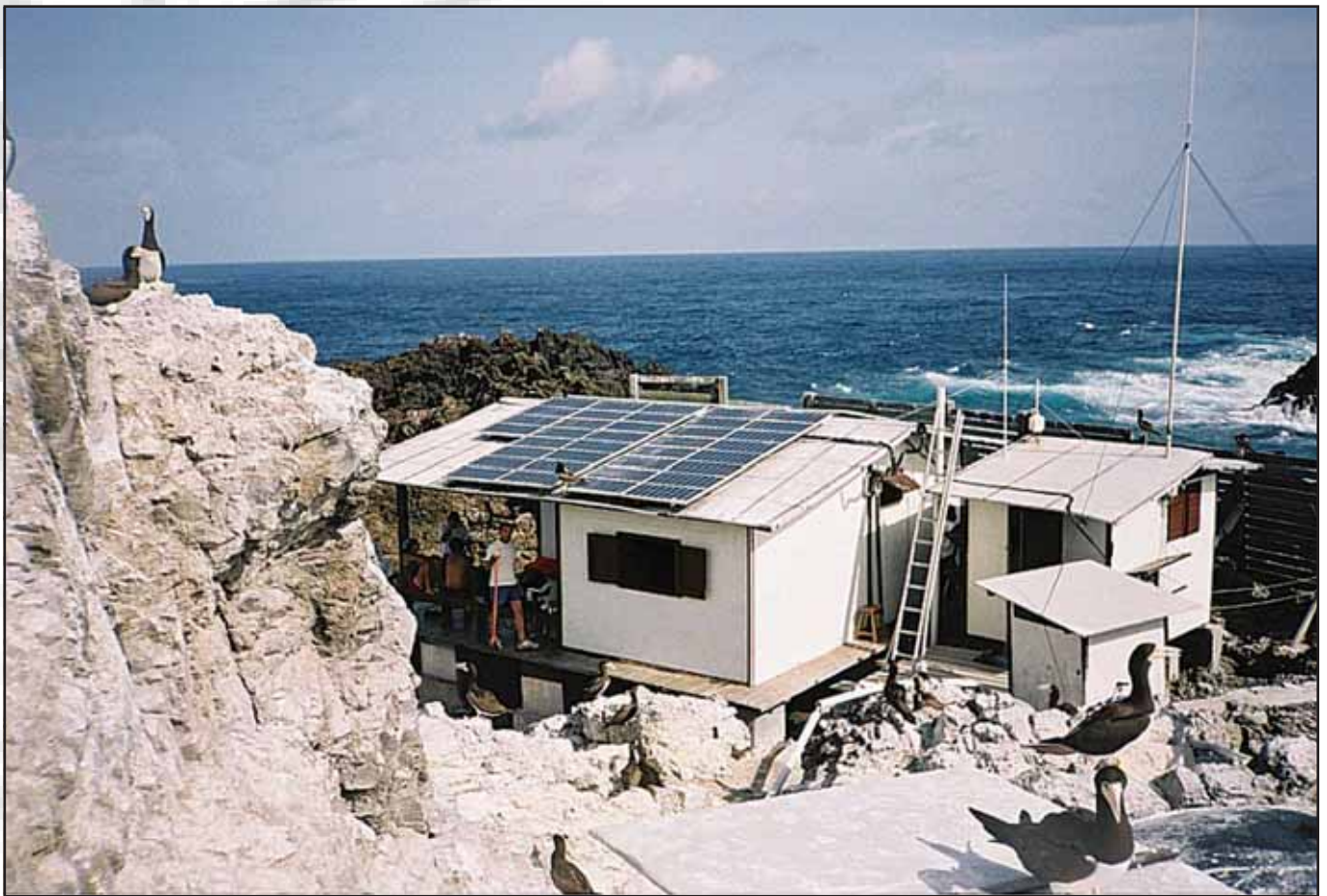
Painéis fotovoltaicos fornecem energia elétrica à Estação Científica do Arquipélago de São Pedro e São Paulo.
