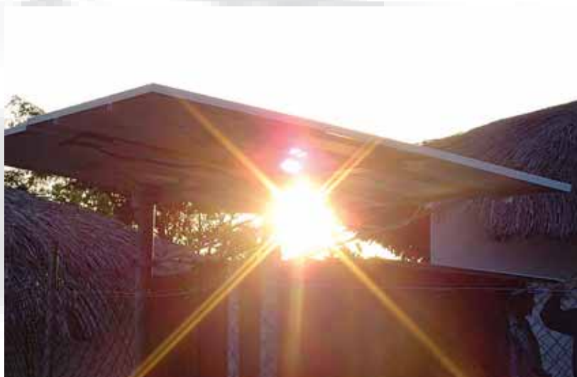
Sistema fotovoltaico de energia instalado no Acre.
