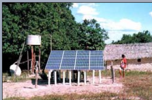
Sistema de bombeamento da comunidade de Boa Sorte Município de Dianópolis
