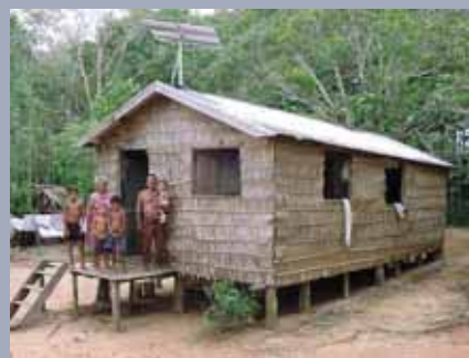
Sistema solar fotovoltaico instalado em N.S.P. Socorro – Manacapuru
