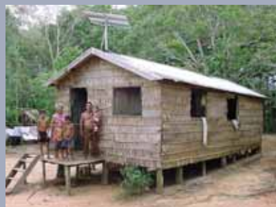
Sistema Fotovoltaico N.S.P. Socorro - Manacapurú
