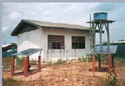
Sistema energético no posto de saúde e bombeamento da comunidade de Lago Novo Município de Tartarugalzinho - AMAPÁ
