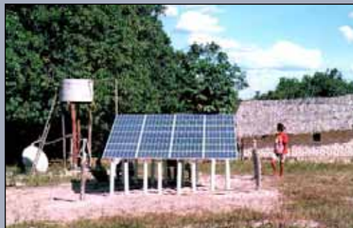
Sistema de bombeamento da comunidade de Boa Sorte Município de Dianópolis
