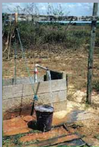
Abastecimento comunitário de água da comunidade de Amapá Grande Município de Amapá - AMAPÁ
