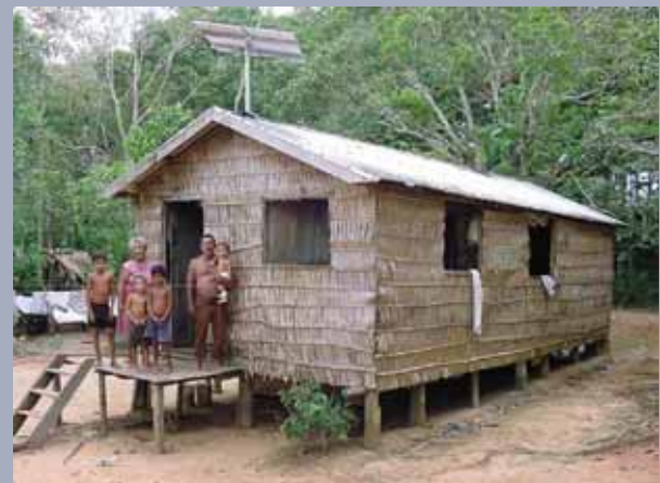
Sistema Fotovoltaico N.S.P. Socorro - Manacapuru
