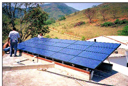
Sistema energético da comunidade de Água Fria - Município de São Fidélis
