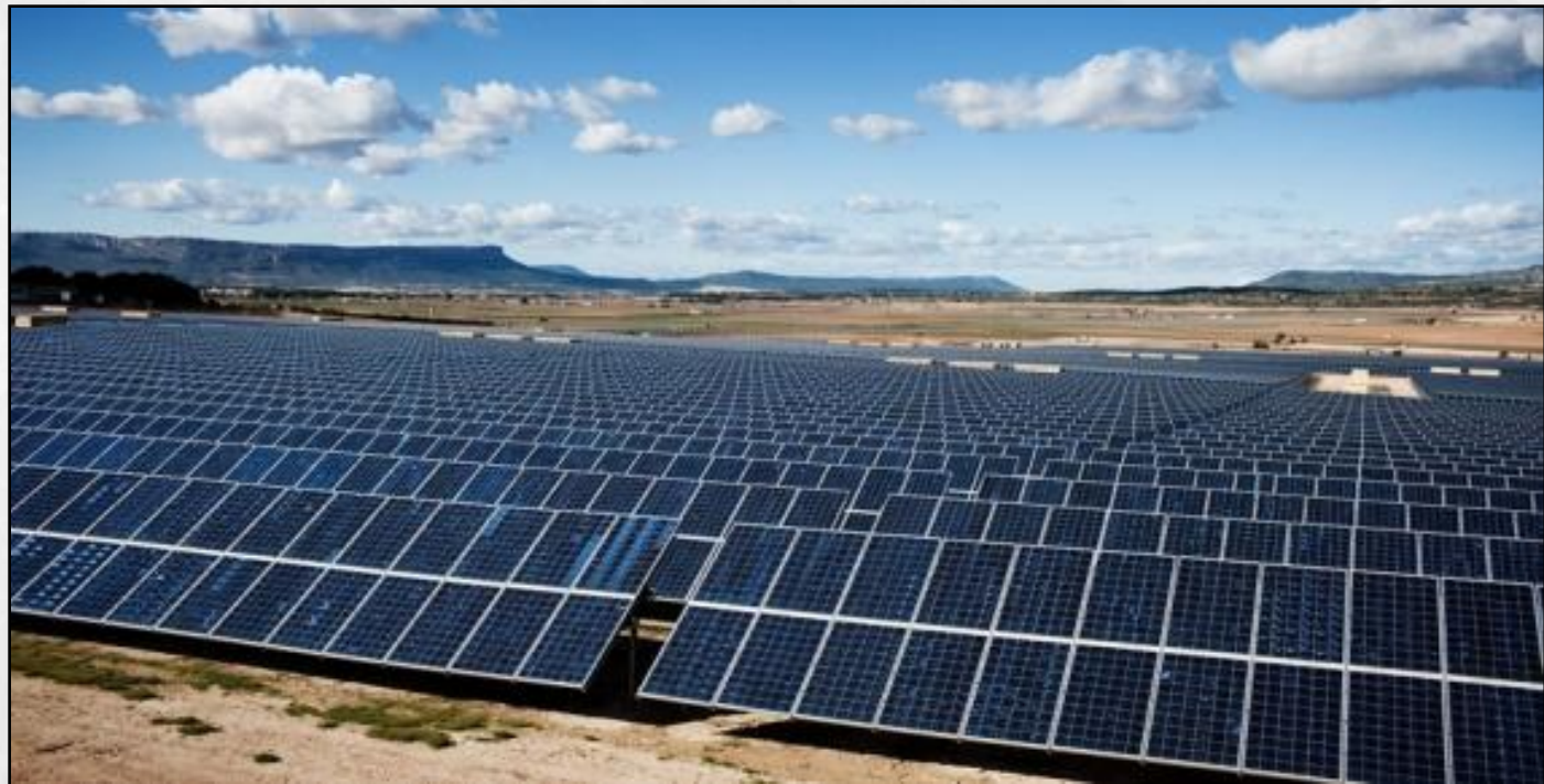
Parque Solar Ituverava (BA) 254 MW
