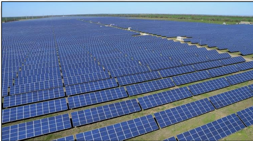
Parque Solar Nova Olinda (PI) 292 MWp
