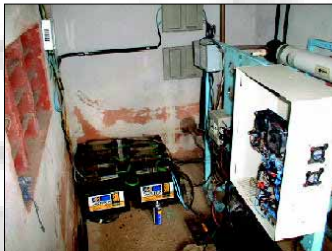
Instalação de osmose reversa composta por baterias, conversor e dessalinizador.
