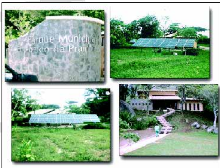
Sistema instalado no Parque Municipal Ecológico de Prainha.
