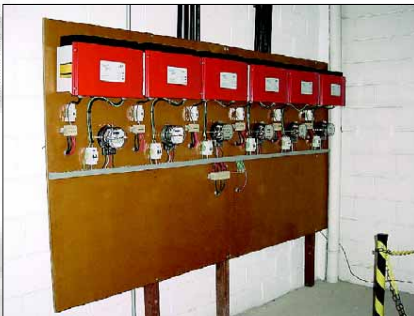
Detalhe da instalação dos módulos fotovoltaicos e vista geral do quadro de inversores e medidores.
