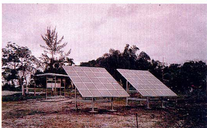
Foto 5: Carregamento comunitário de baterias, em Ararapira (PR)
